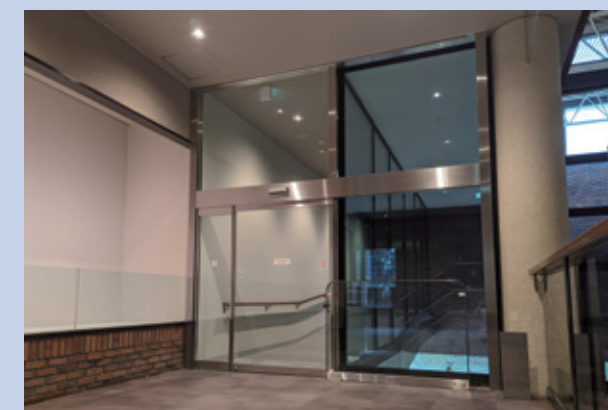
自動扉 温湿度管理のために設置しました。
